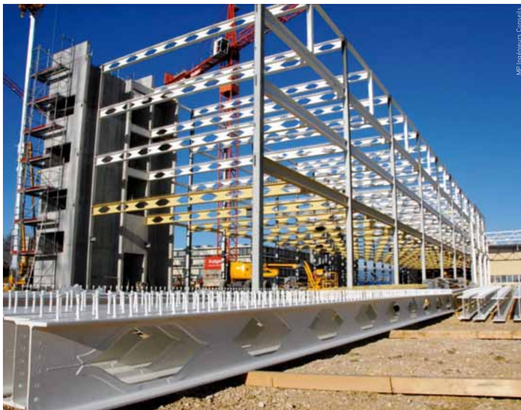
Extension de BOBST SA à Mex : structure métallique mixte R60, modulaire et fonctionnelle, sans protection passive dans les bureaux.
