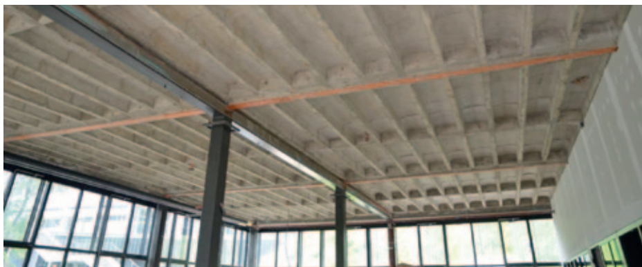
Théâtre de l'Arsenic à Lausanne: Protection des nervures en béton et des colonnes métalliques évitée grâce aux calculs avancés.
